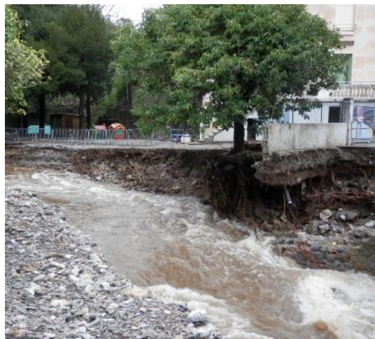
Mur de l'école de Lastours emporté par la crue de l'Orbiel en 2018
