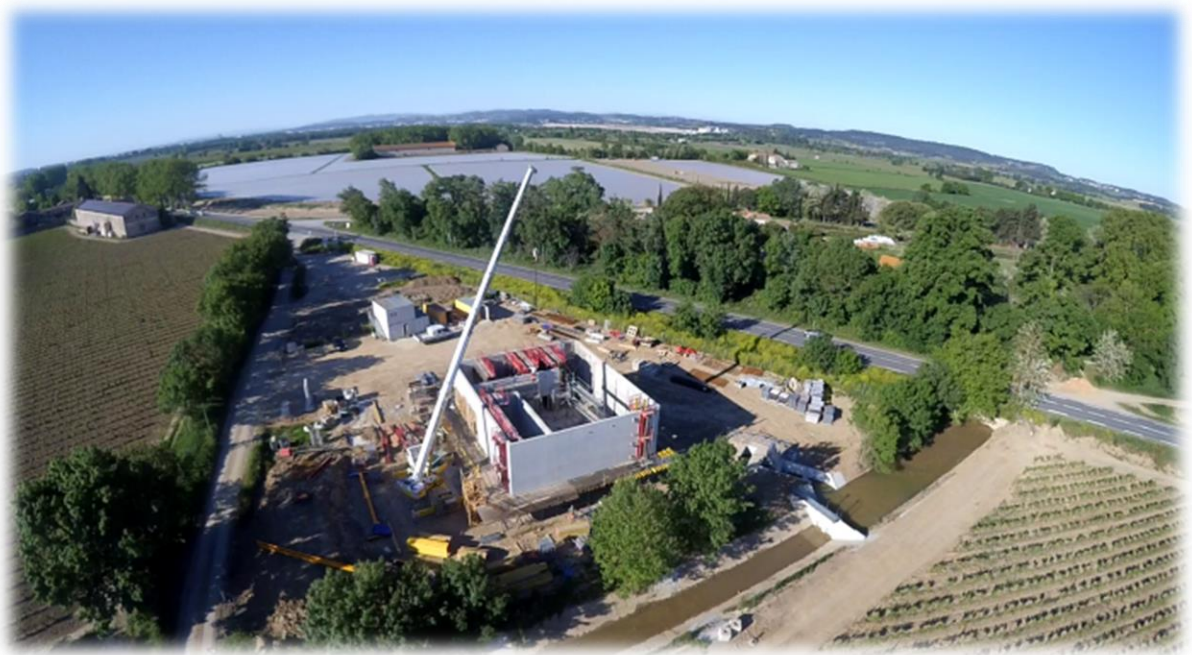
Stations de pompage de Raonel
